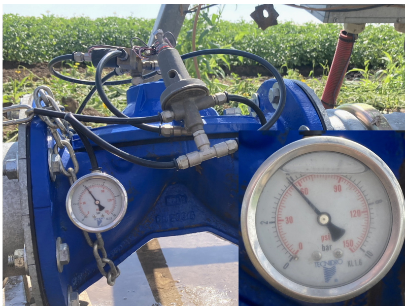
Рисунок 7 – Давление воды на выходе подводящего водовода
