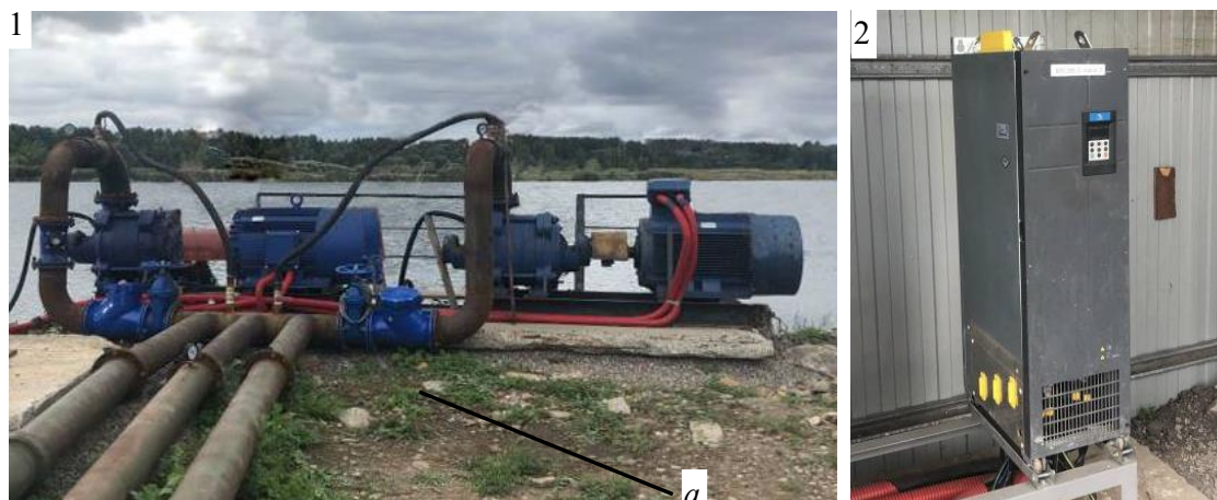
Рисунок 4 – Общий вид насосной установки с частотно-регулируемым приводом
